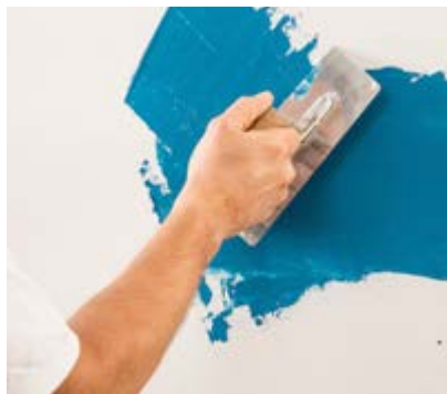
Nach dem Grundieren der Fläche mit Iso-Mineralgrund 309 wird die 1. Lage Stucco Romano mit der Traufel aufgetragen.
