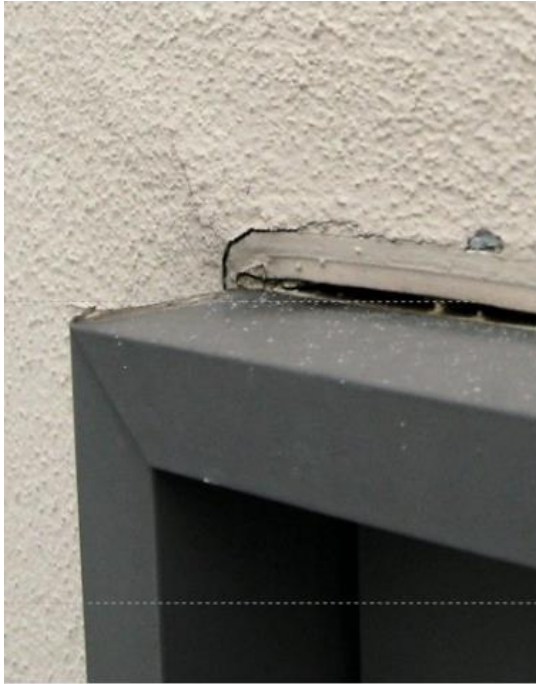
Abb. 1 Der Versuch die Anschlusssituation mit einer Anputzleiste zu lösen; solche Anschlusslösungen führen meist zu Schäden am Wärmedämm-Verbundsystem.
