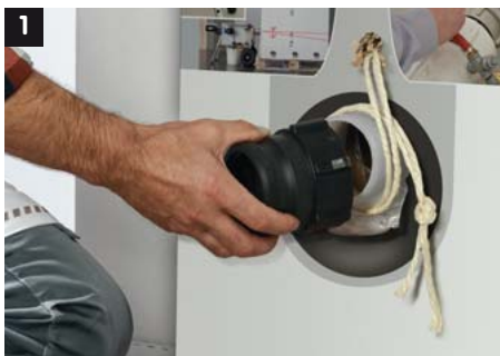
1 Schutzkappe entfernen, Kamlock-Kupplung anbringen
